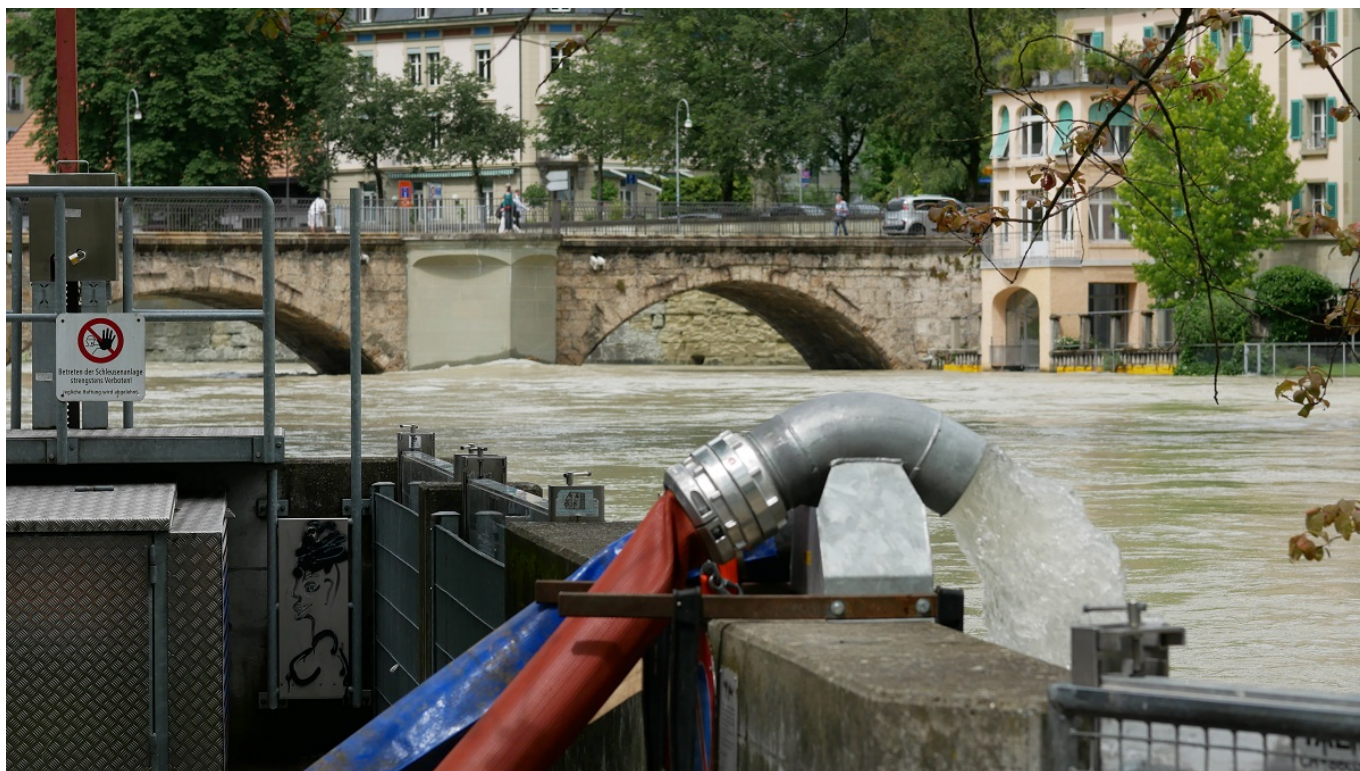
Насосы для откачивания воды в Берне. Фото: Nashagazeta.ch
